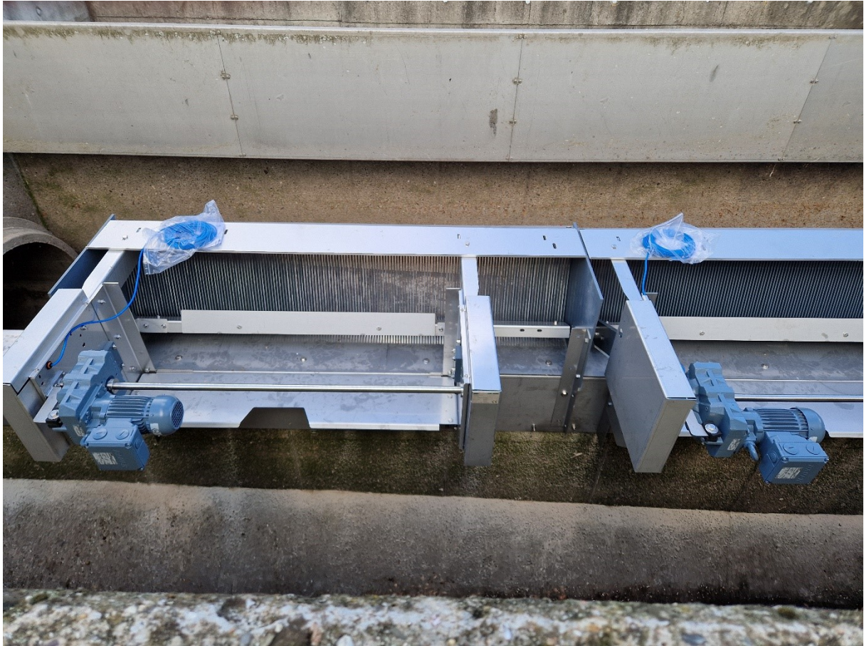
(Rechenanlage RÜB Niedermendig)
