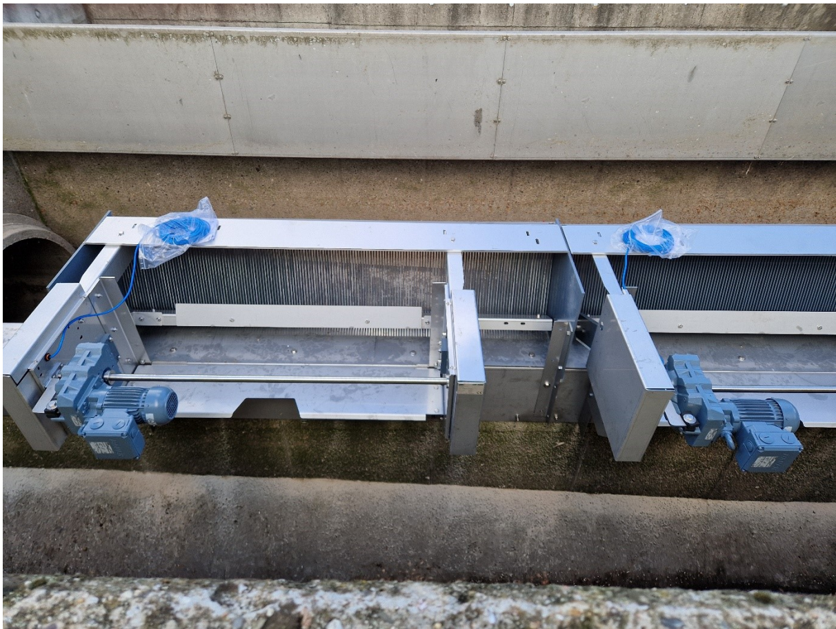
(Rechenanlage RÜB Niedermendig)
