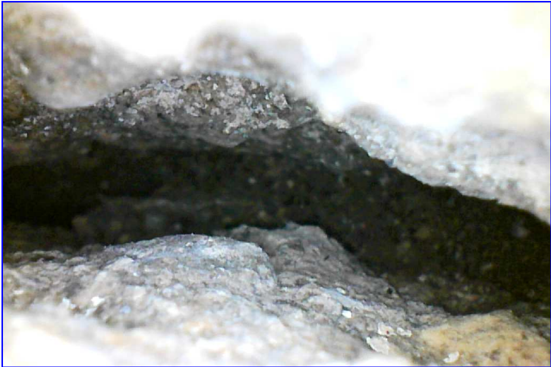
Abb. 27: Innenansicht des Risses von Abb. 25
